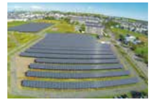
釧路望洋発電所
